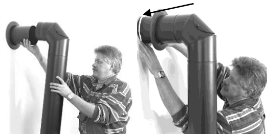
Abb. 1: Anschluss Rauchrohr am Schornstein
