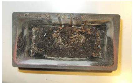
BEISPIEL VERSCHMUTZTE BRENNSCHALE
