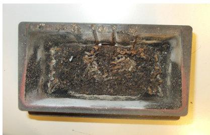
BEISPIEL VERSCHMUTZTE BRENNSCHALE
